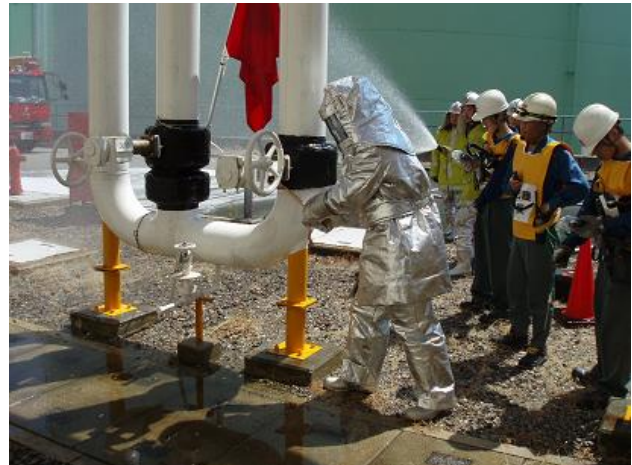
LPガス漏洩箇所への応急措置
