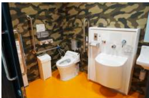
< 4F：多目的トイレ >
