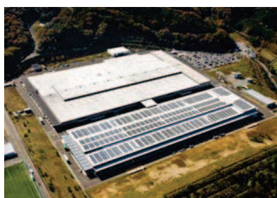
太陽光発電システム（設置例）
