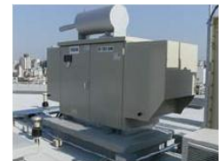
非常用発電機(参考写真)
