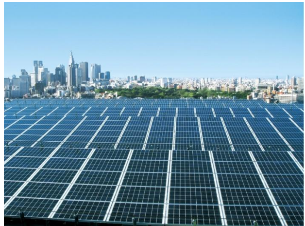
※伊藤忠商事 東京本社ビル （太陽電池容量 : 100kW）
