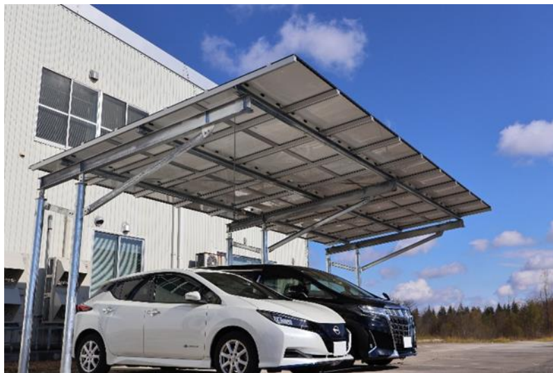
▲ソーラーカーポート「E-port R」全景
