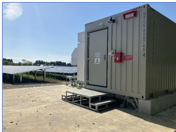
太陽光発電設備を併設したグリーンデータセンター
