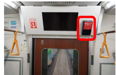
車内防犯カメラ(設置例)
