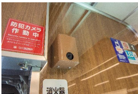
▲既存の防犯カメラ設置例(1500系など)
