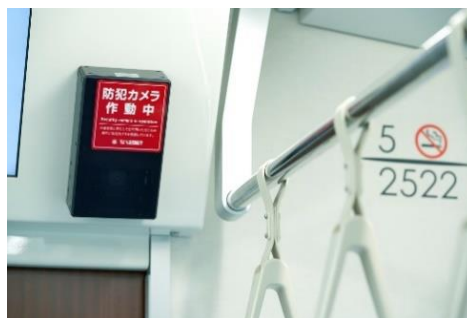
▲既存の防犯カメラ設置例(2020系など)
