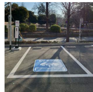
▲EV充電スタンド
