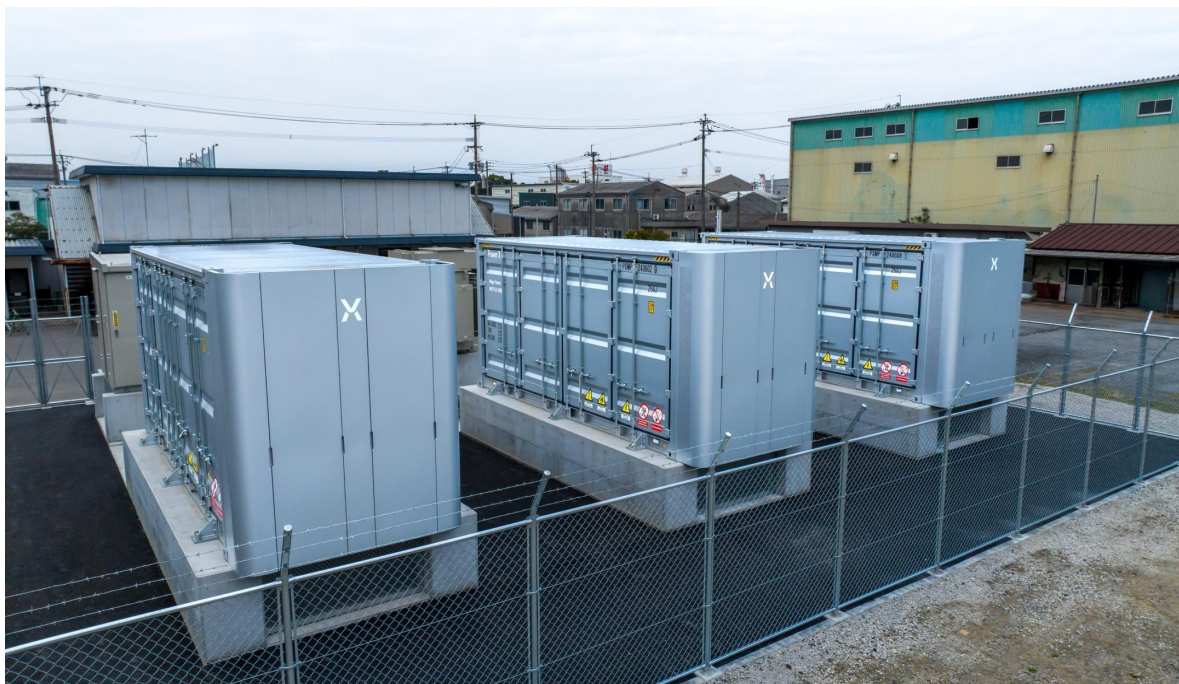
画像：Mega Power を採用した福岡若松蓄電所（福岡県北九州市）
