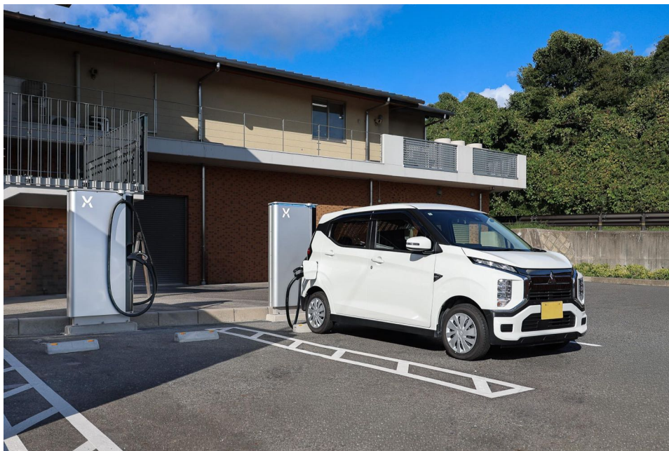
画像：道の駅 妹子の郷 EV 充電ステーション
