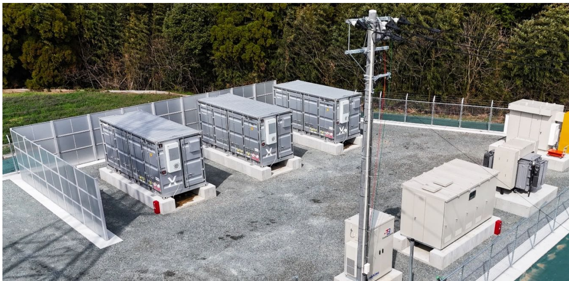
「植木町蓄電所」（熊本県熊本市）
