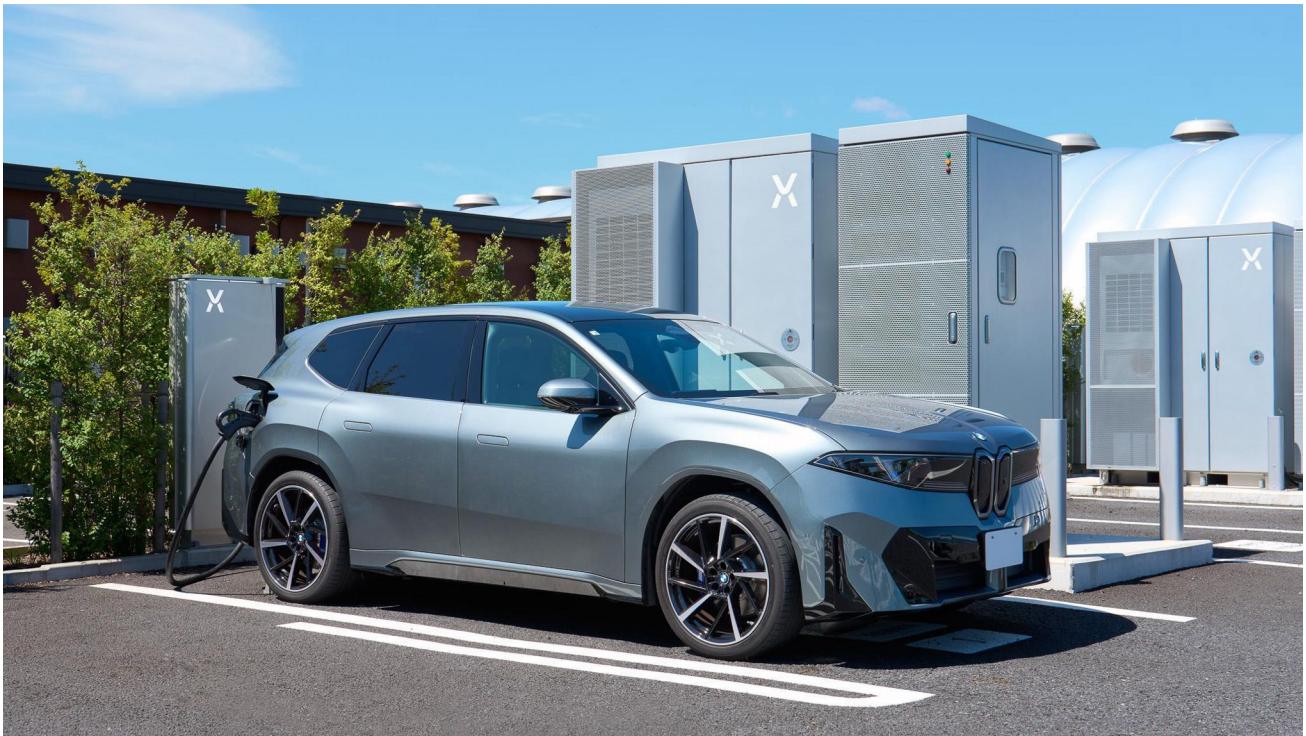
画像：高電圧充電に対応した EV チャージステーション（東京都江東区）
