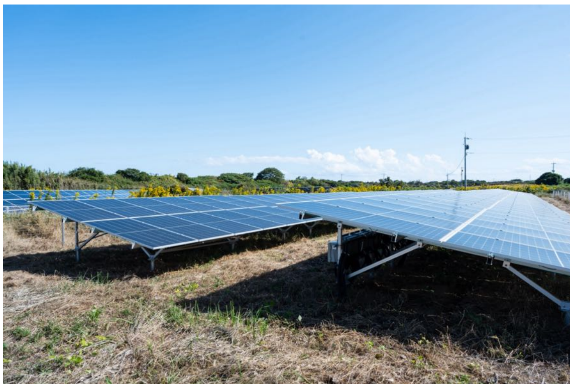
パワーエックスがパートナー企業を通じて新設した太陽光発電所（茨城県）
