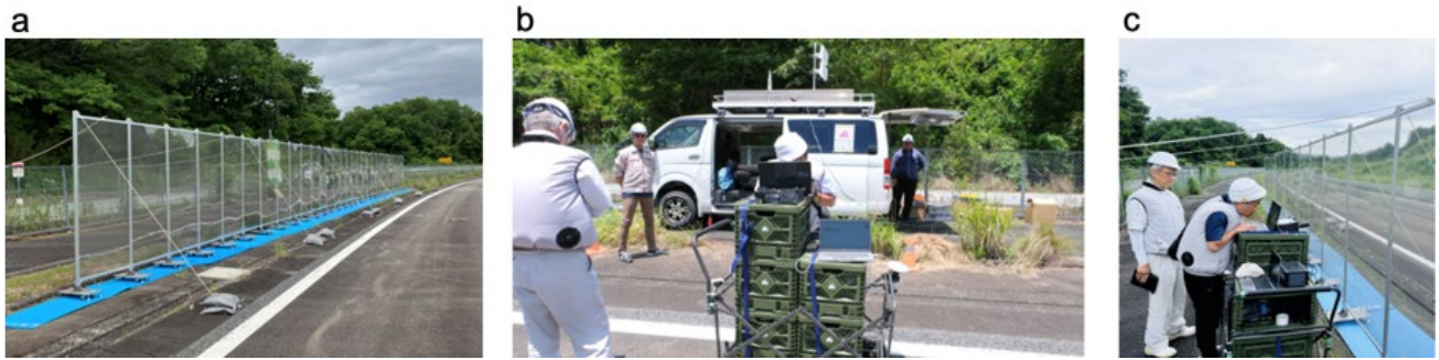
写真：高速道路における DAS および電波反射板を用いた実証実験の様子
