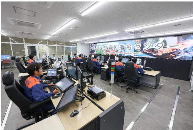
山口西部消防指令センターの指令室
