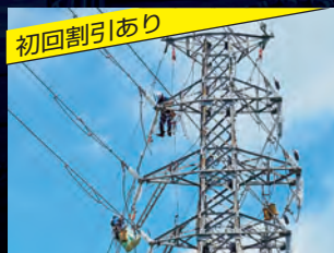
初回割引あり 鉄塔メンテナンス資材運搬 架線・延線工事支援
