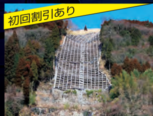
初回割引あり 中山間地域での土木工事 資材運搬 / 索道工事支援
