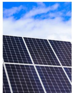
太陽光発電所
