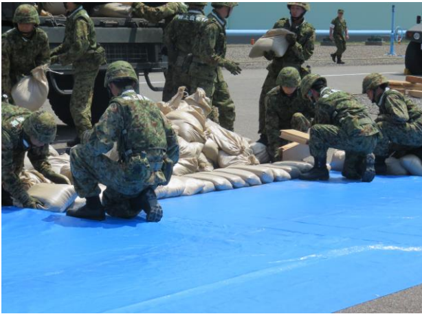
防油堤亀裂・崩壊箇所の防水シート・土嚢補強
