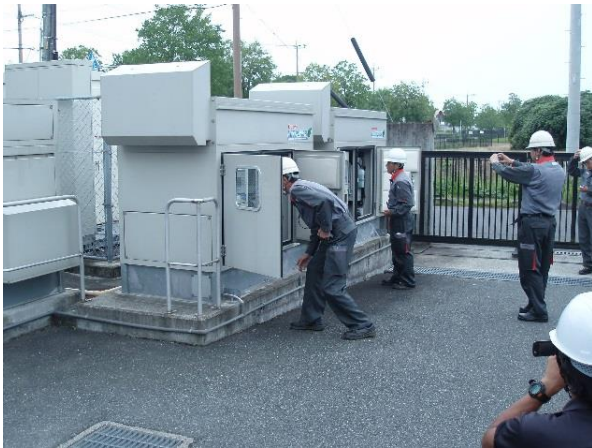
非常用電源設備訓練
