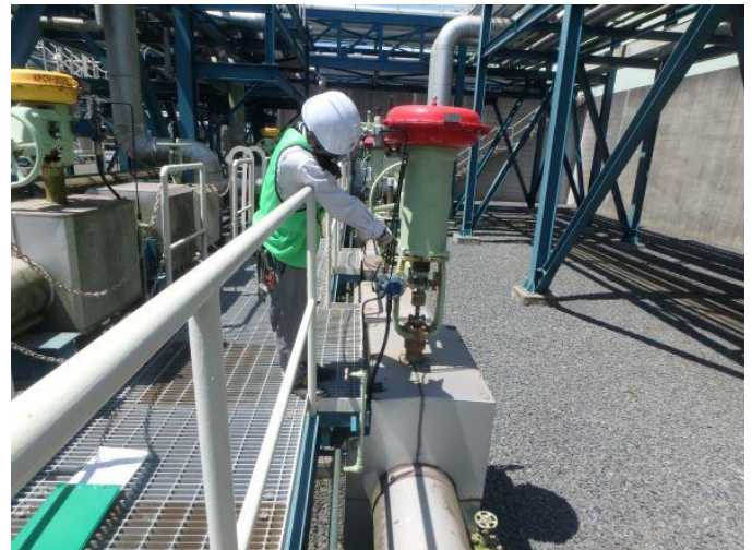
調節弁閉止確認(放出終了)
