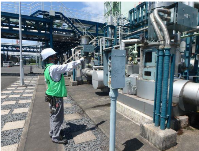
ポンプ起動確認(放出開始)
