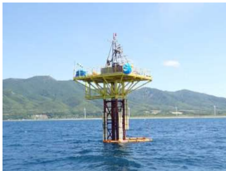
令和5年度 海底地盤調査サイト(鋼製檣によるボーリング)
