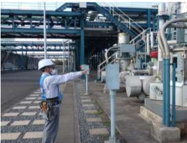
ポンプ起動確認(放出開始)
