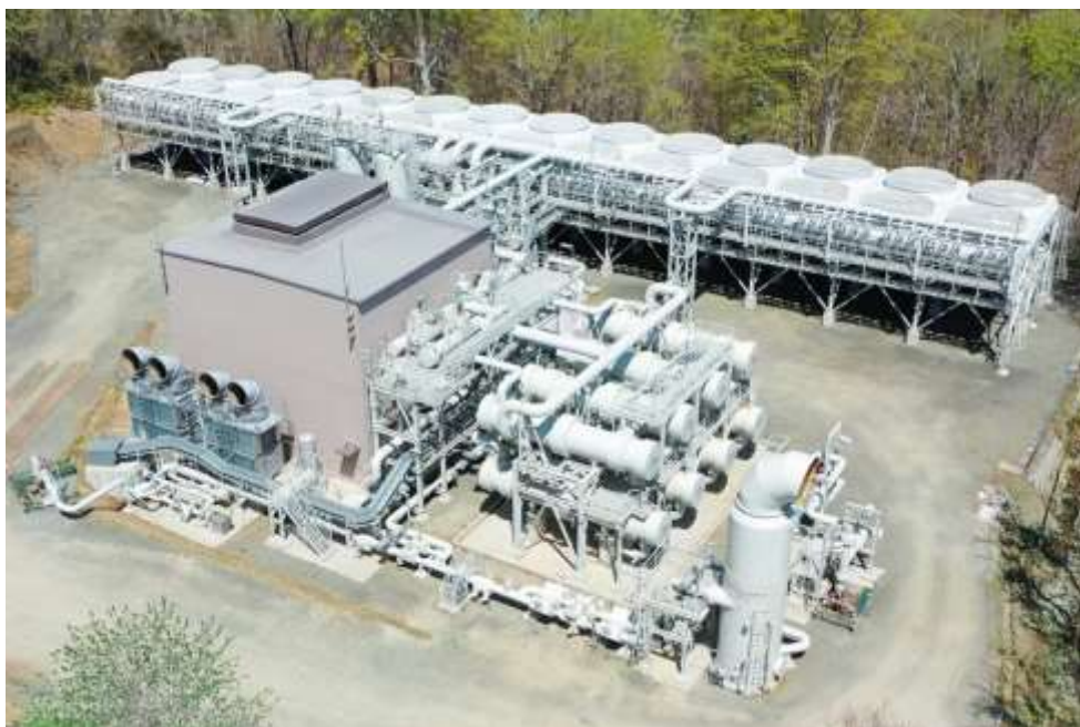
南茅部地熱発電所外観(提供:オリックス株式会社)
