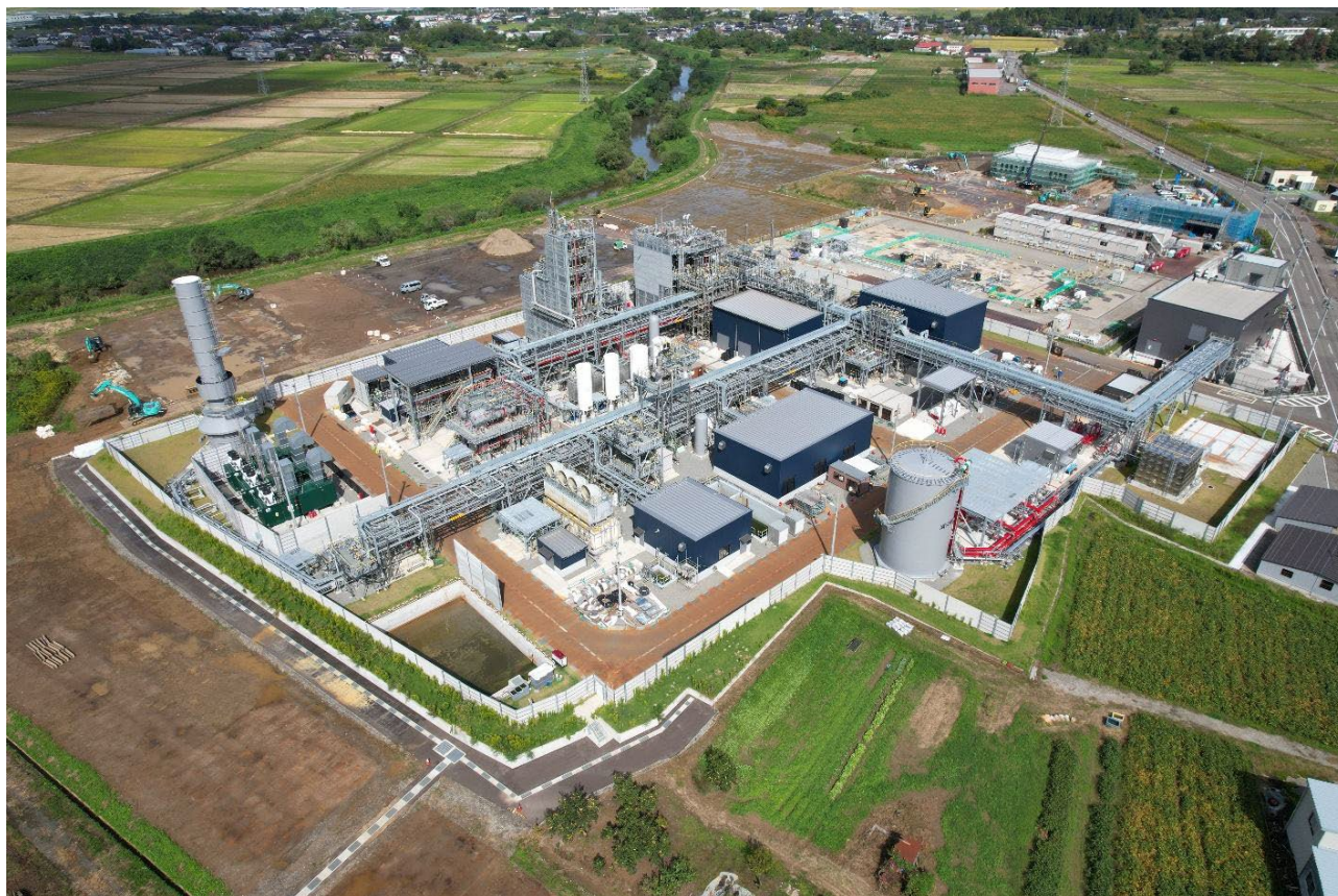
図 2 実証プラントの全景
