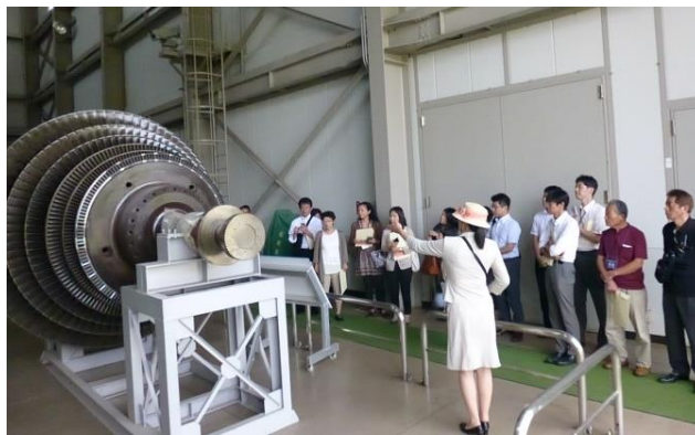
8月9日に開催された地熱見学ツアー (山川地熱発電所)
