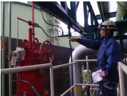
基地間の境界弁確認
