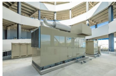
72 時間対応非常用発電機
