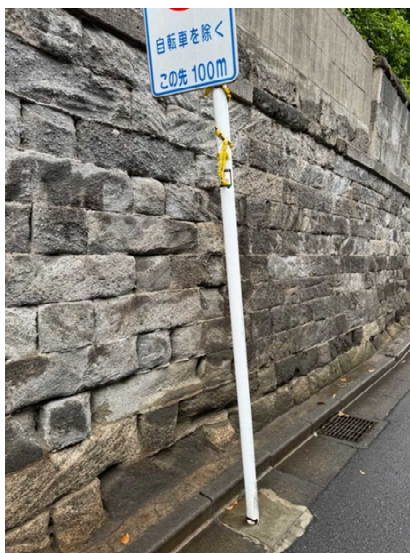
図1 道路附属物破損の例（傾いている標識）
