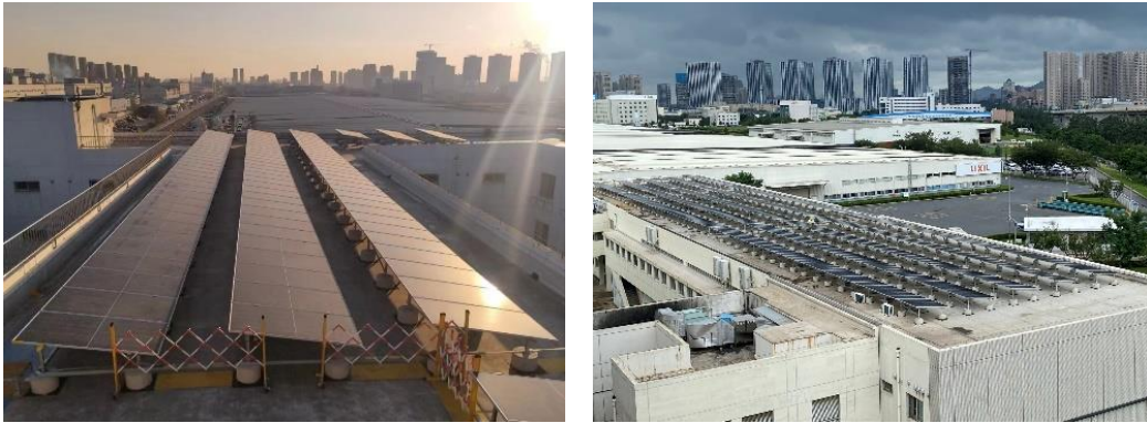
大連工場（中国）でオンサイト PPA による太陽光発電システムを導入
