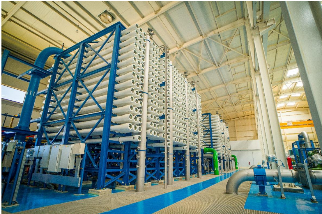
JICA が円借款を通じて建設を支援した海水淡水化プラント。
