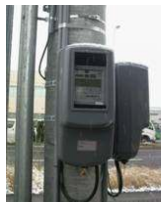
プラネット東北設置の売電メーター
