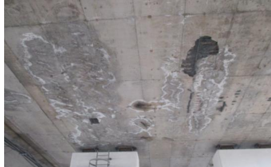
床版下面の損傷状況
