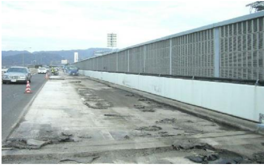
床版上面の損傷状況
