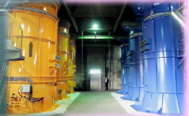
一般公開は初めての関門トンネル換気設備です!
