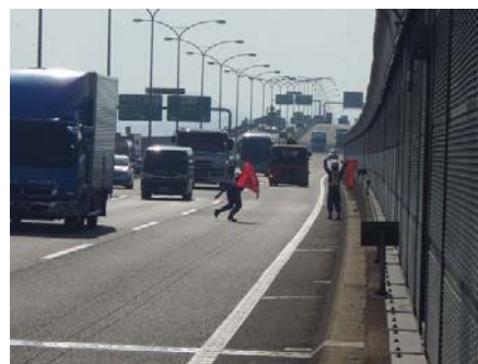
《落下物排除状況》
