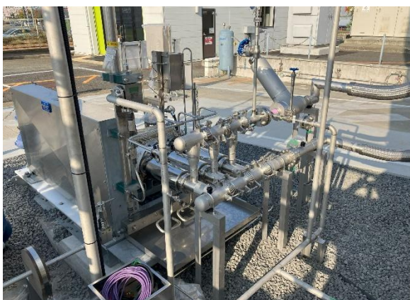
現地に設置されたポンプスキッド
