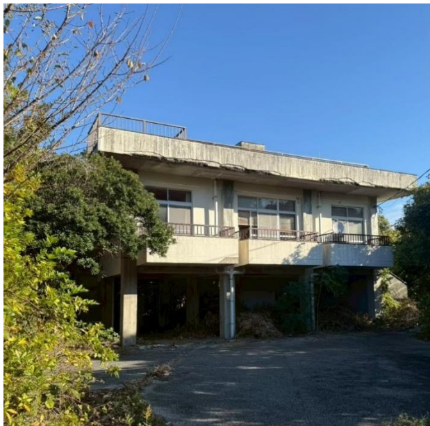
▲築40年。手入れが届かず自然に侵食されるがまま放置されていた負動産
