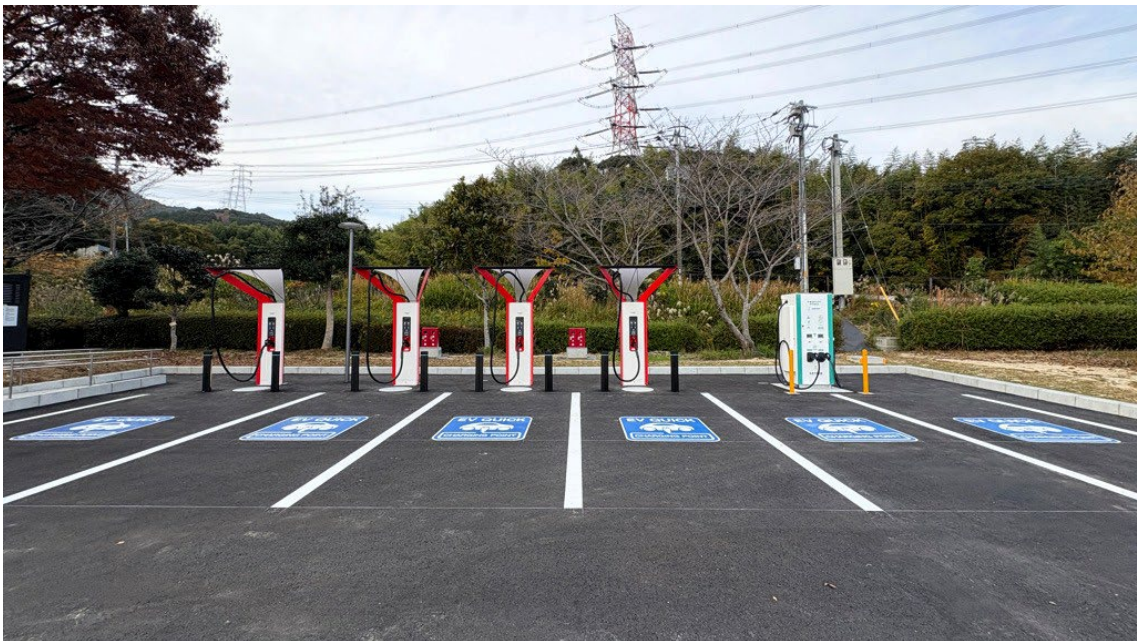
「赤いマルチ」を含む急速充電器2基（6口）を整備した急速充電ステーション （九州自動車道 基山パーキングエリア（上り））
