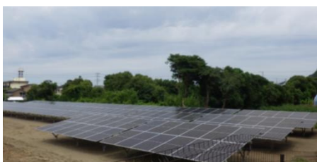
ペリエ太陽光発電所館山那古
