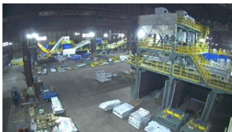
全景 (ケミカルリサイクル用原料製造設備)
