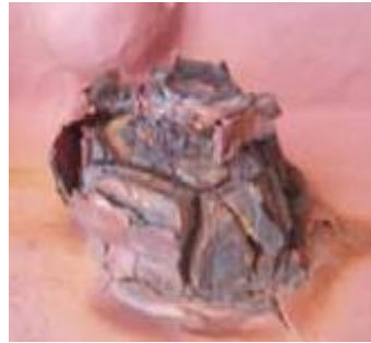
高力ボルトの腐食
