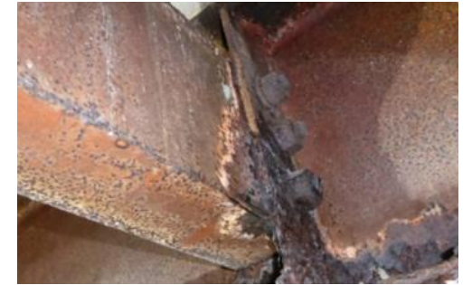
主構造部位(ボルト接合部)の腐食
