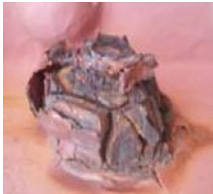
高力ボルトの腐食
