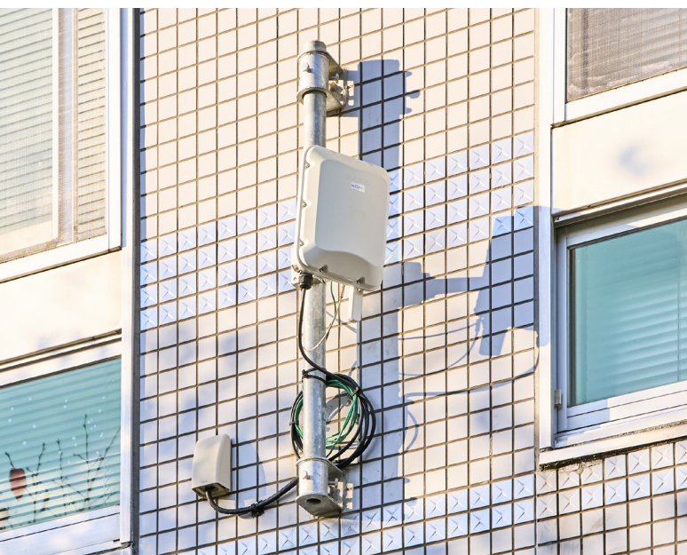
全方向アンテナおよび指向性アンテナのアクセスポイントを適切に配置することで、電波カバレッジを広範囲に拡張
