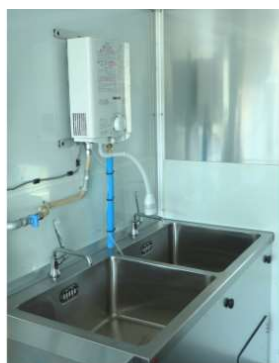
浄水機能付き水道と給湯器
