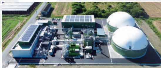
写真提供：かぶとファーム発電所
