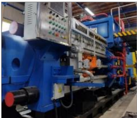
(図4) 導入した押し出し加工設備
