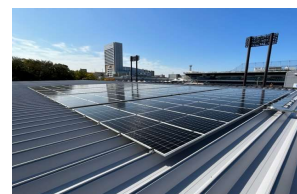
「太陽光発電システム」
