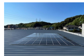
太陽光発電システム
