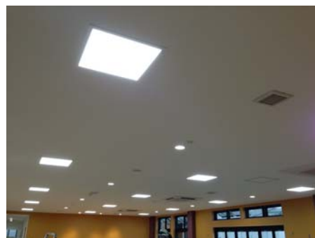
全館LED照明
